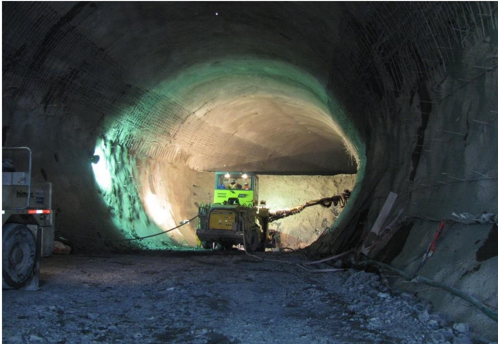
Túnel San Pedro (Hidro-El.)
